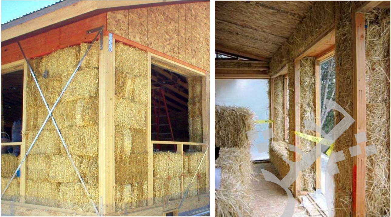
شکل شماره «۶۵»: نمونه‌هایی از دیوارهای ساخته شده با کاه فشرده که در اکثر روستاها در دسترس می‌باشد. از چوب به طور وسیع در کلاف‌های رواداری‌ها و همچنین به عنوان تیر و ستون استفاده شده است. در تصویر سمت راست از قطعات فلزی سبک برای مهار نیروهای جانبی و به عنوان بادبند استفاده شده است.
